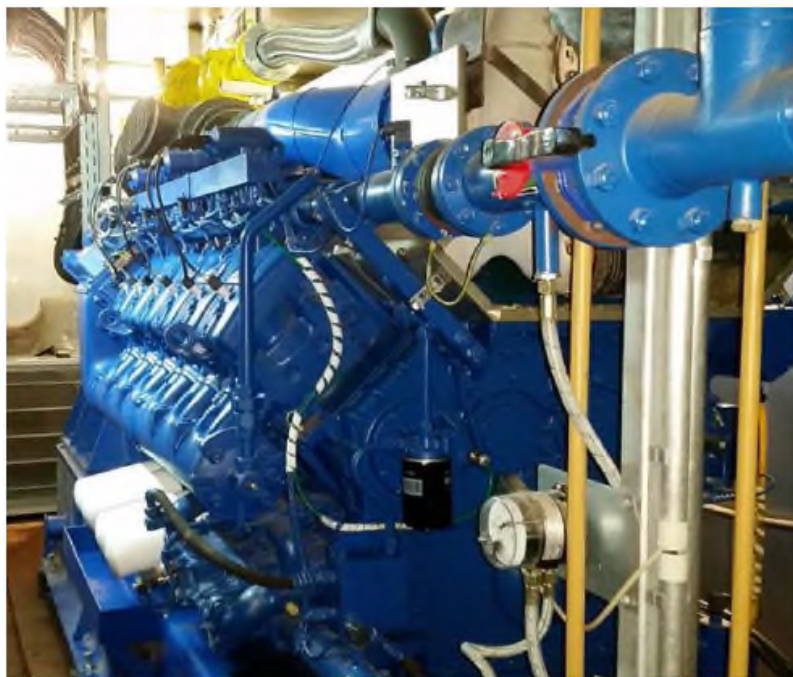
Detalle motor cogeneración
