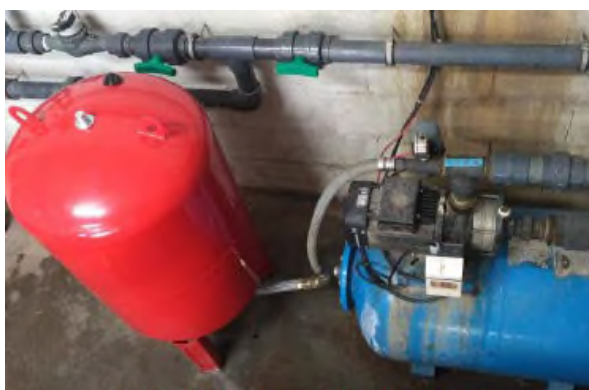
Detalle Instalación nuevo Calderin junto con la Bomba
