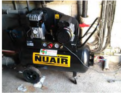
Detalle Compresor nuevo instalado en Caseta de Bombas
